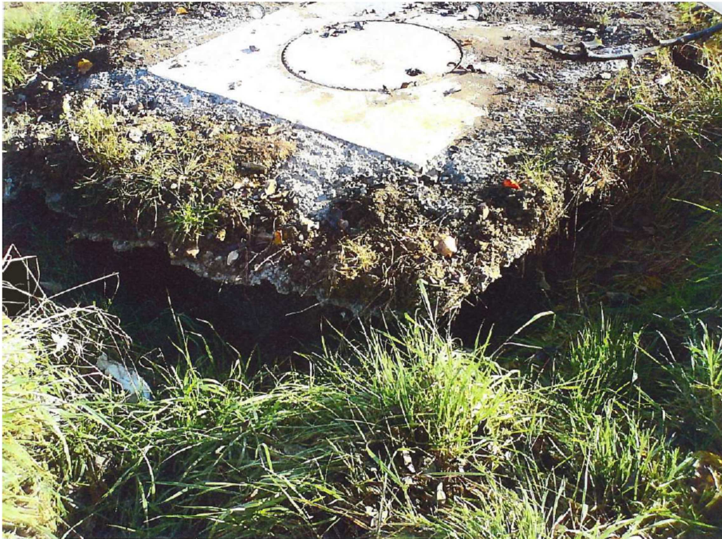
Stauraumkanal Orbis: Wasseraustritten und Flurschaden
